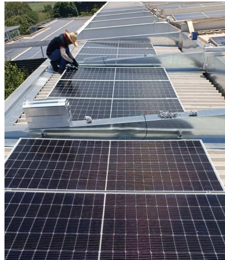
Figura 2) Placas fotovoltaicas interligadas para formarem duas strings com tensão média de 600V.
